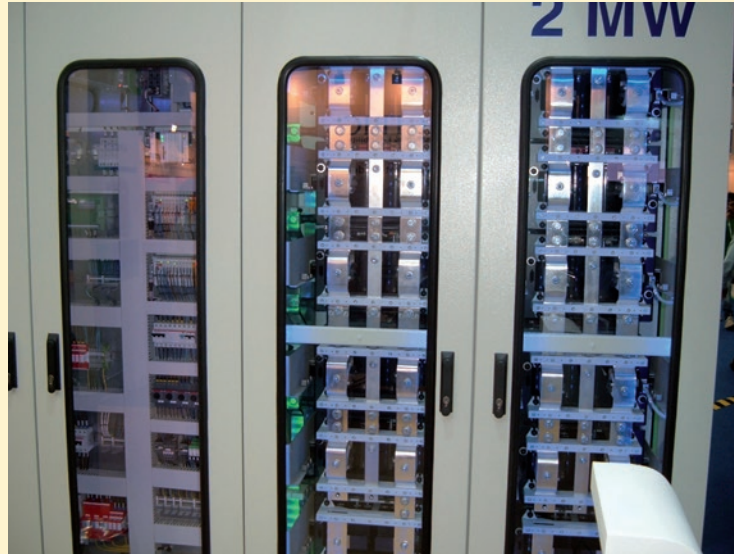
Zabezpieczenie półprzewodników wewnątrz przekształtnika średniego napięcia.
