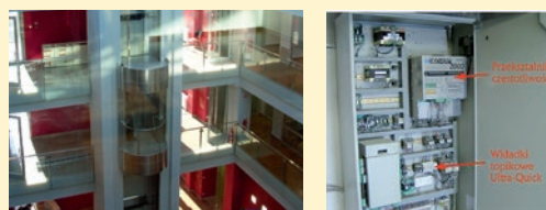
Przekształtnik częstotliwości dla silnika 3-fazowego AC (napęd windy)
